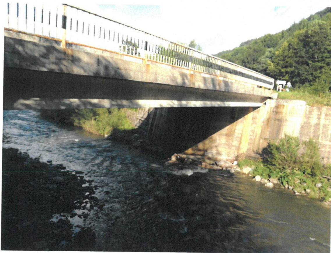
Foto nr. 7 – Modificări ale regimului hidraulic, coborârea etiajului în zona podului, afuierea infrastructurilor
