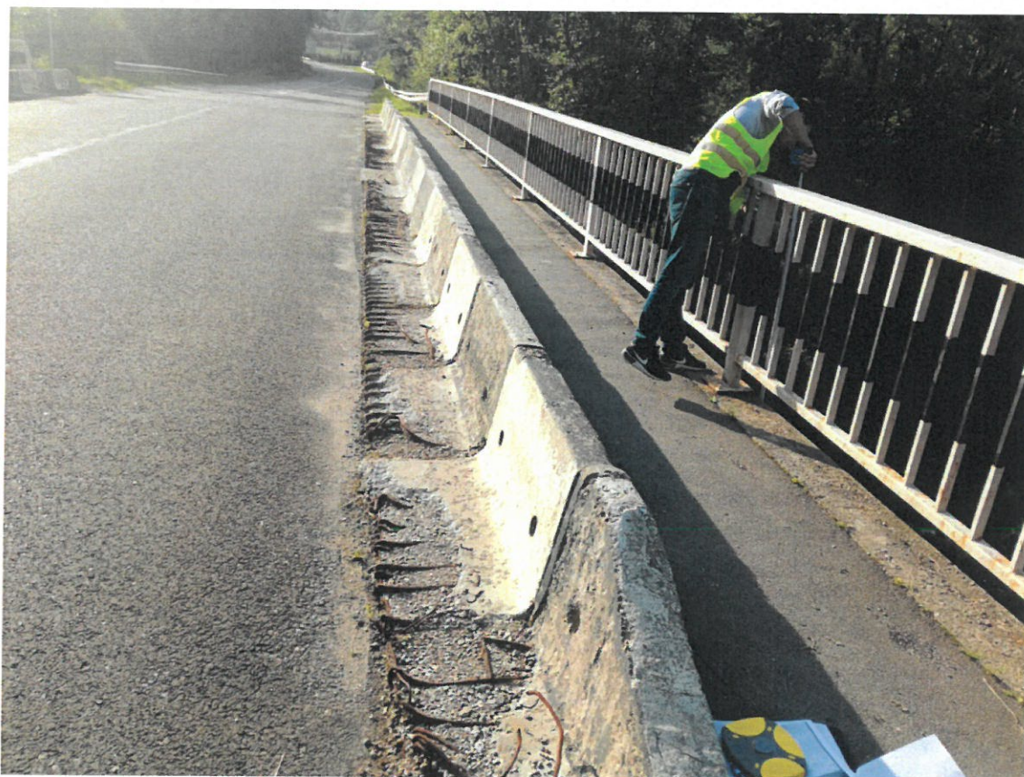
Foto nr. 9 – Coroziunea armaturilor la bordurile inalte
