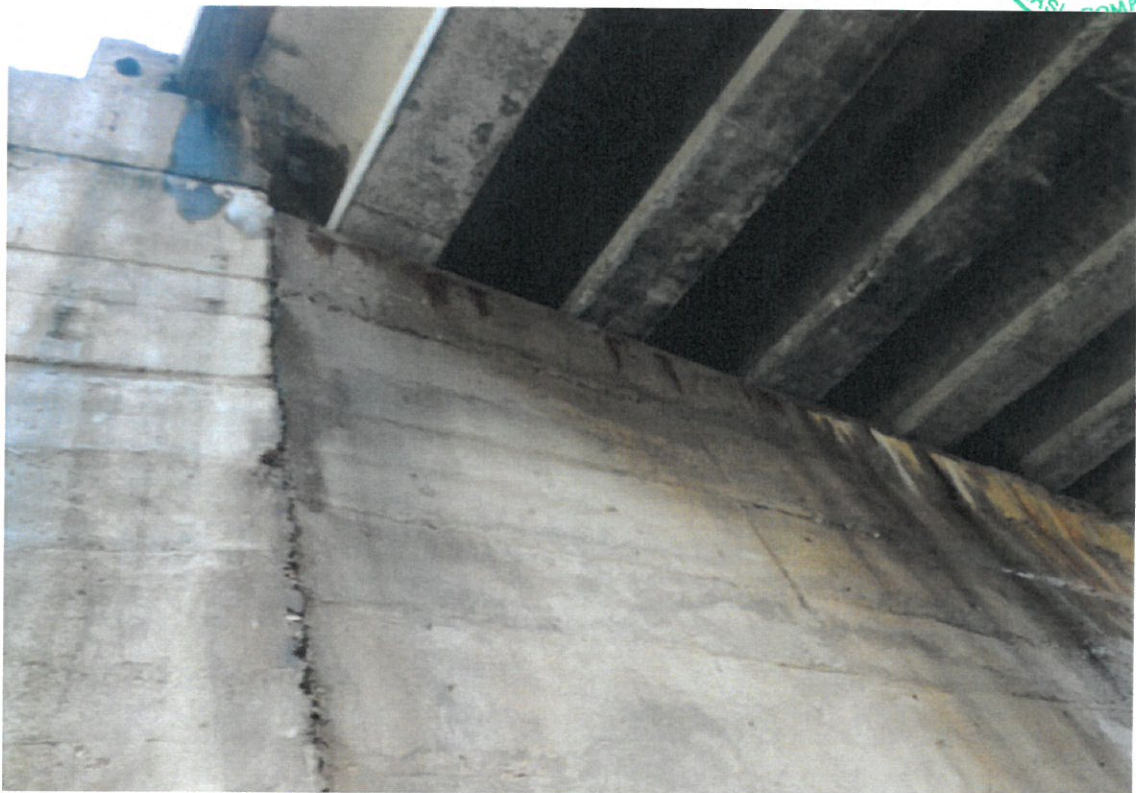
Foto nr. 6 – Lipsa dispozitivelor de protecție la acțiuni seismice
