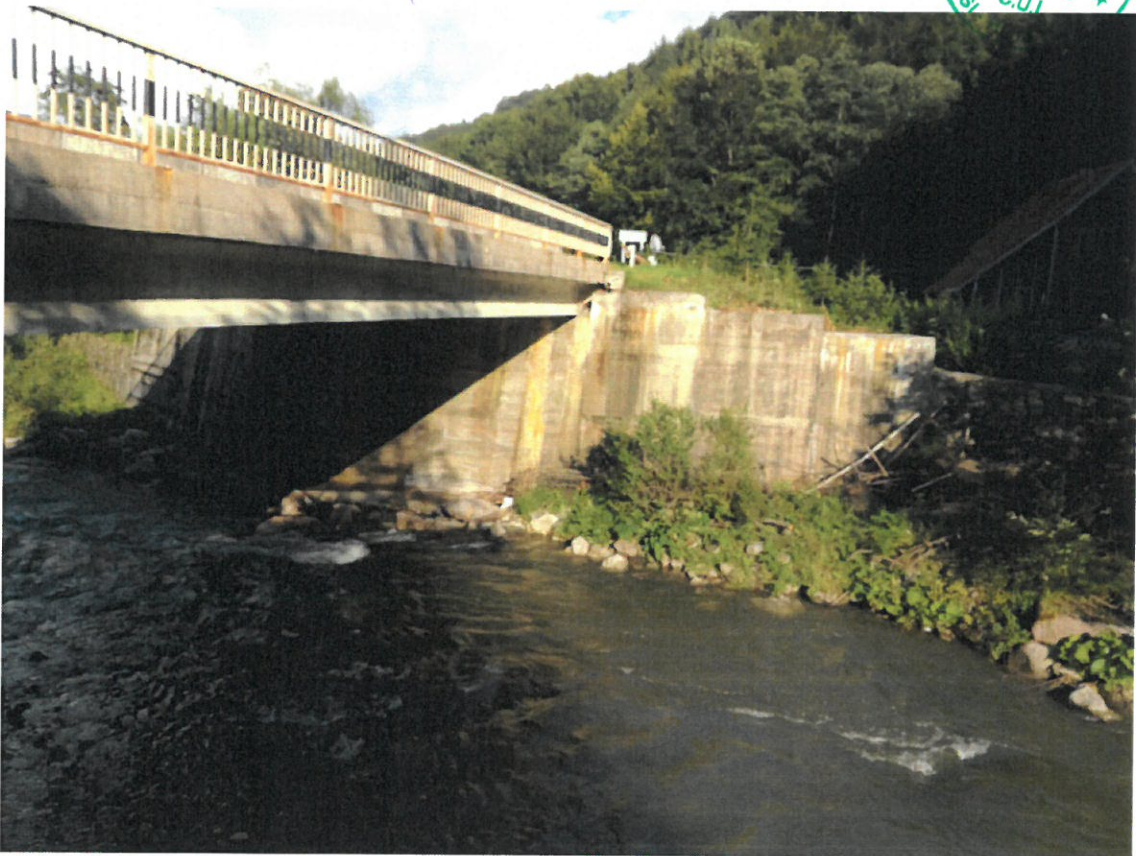
Foto nr. 14 – Albia râului prezinta in amplasamentul podului un traseu sinuos, fapt favorizat de ruperea malurilor care au căzut in albie, afuierea albie cu cca. 1,00 m
