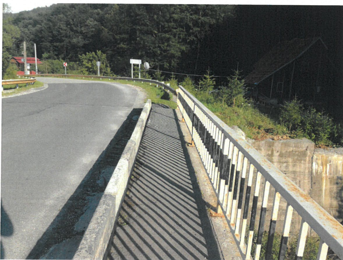
Foto nr. 10 – Fisuri sau crăpături în îmbrăcăminte (asfaltică sau din beton de ciment), faianțarea sau exfolierea acesteia
