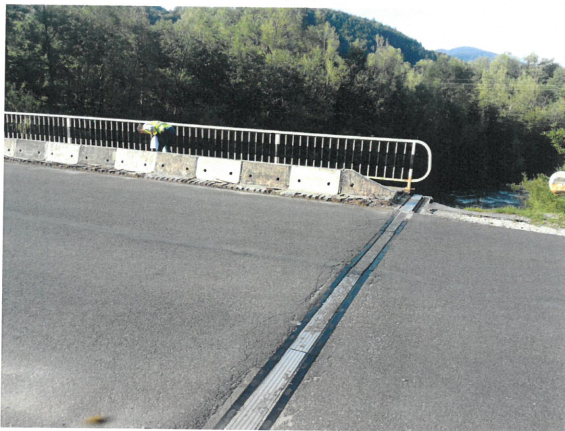
Foto nr. 8 – Distrugerea dispozitivului de acoperire a rosturilor pe culei, fisuri și crăpături, infiltrații în zona rosturilor de dilatație
